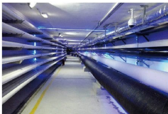
青海海东管廊
